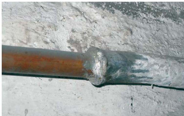
Sofern Trinkwasser fließt, müssen Bleileitungen bis Anfang 2026 ausgebaut oder stillgelegt werden. Foto: KBreker / CC BY 3.0
